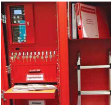
Primer požarne omare, v kateri so gasilec na voljo ključi, načrti objekta, požarni in evakuacijski načrt, lahko pa tudi določeni pripomočki in orodje.
