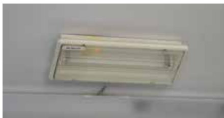
Varnostna razsvetljava zagotavlja ustrezno vidljivost za varen umik iz prostora ob izpadu električnega napajanja objekta.
