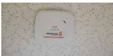
Sistemi za odkrivanje in javljanje požara so eden osnovnih preventivnih ukrepov.
